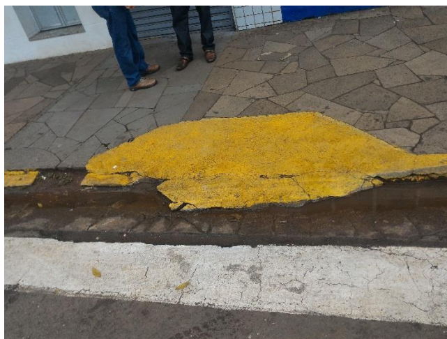
Fig. 16. Rebaixo deteriorado e sem planos inclinados. Fonte: os autores.
