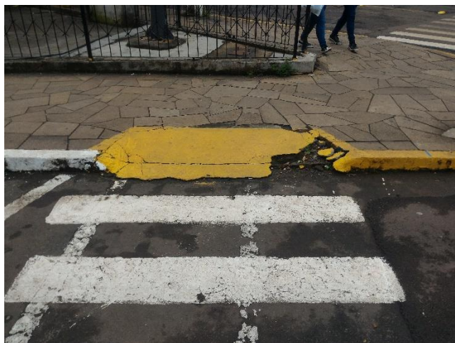
Fig. 17. Rampa deteriorada. Fonte: os autores.
