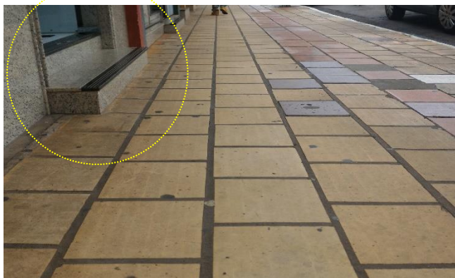
Fig. 4. Irregularidades no uso da calçada. Fonte: os autores.
