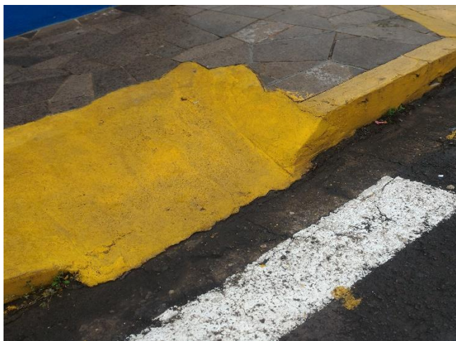
Fig. 15. Rampa inclinada e escorregadia. Fonte: os autores.
